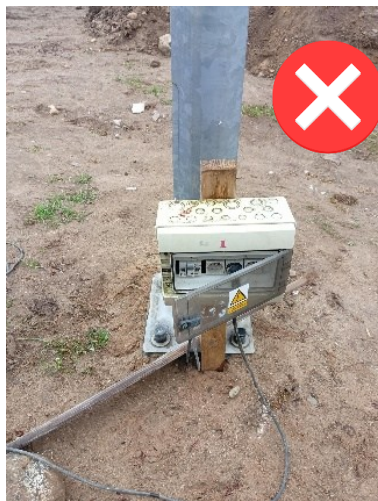
Zdjęcie 2 Zniszczona obudowa rozdzielni elektrycznej
